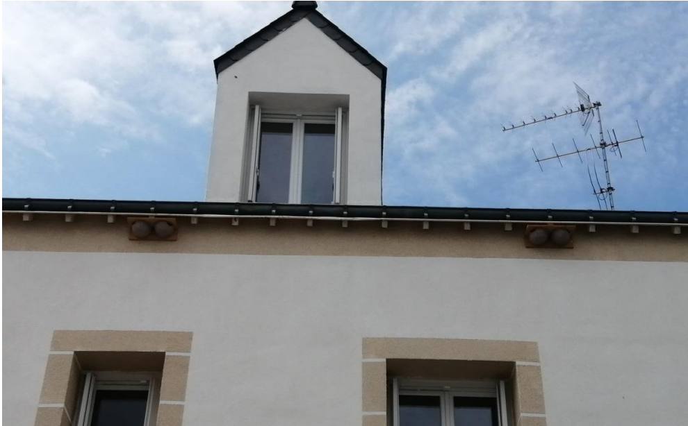
Bande rugueuse sous avancées de toit favorisant la construction de nids naturels avec nids artificiels doubles © LPO Bretagne
