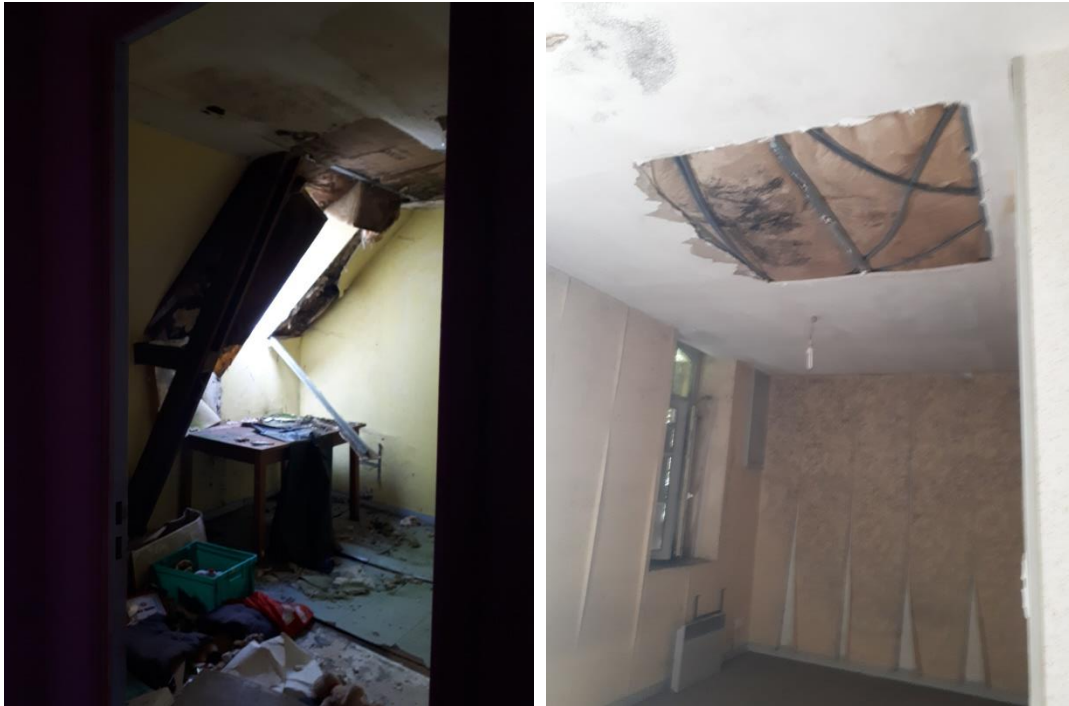
Pièces intérieures des bâtiments détruits © Justine Royer
